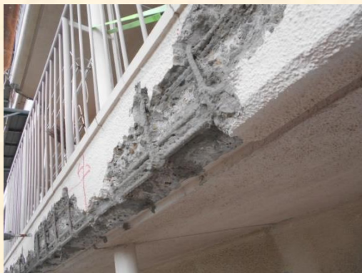
躯体見附部欠損部状況
