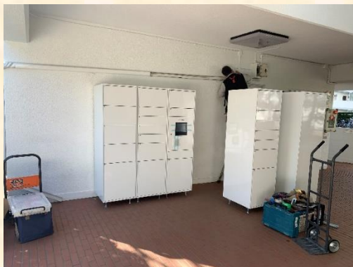
宅配ロッカー設置状況
